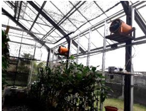
Gambar 25. Instalasi blower-fan untuk mendinginkan ruangan rumah kaca
